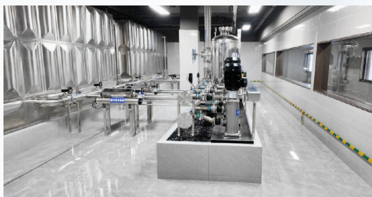
▲ 公开透明的水泵房
